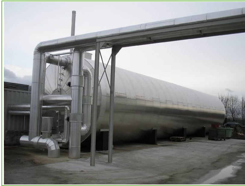
Abbildung 16: Liegender Speicherbehälter mit 300 m 3 Speichervolumen (Quelle: Planungsbüro Goumans)
