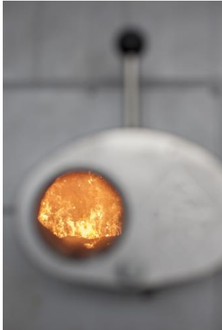
Blick in den Feuerraum eines Bioenergiekraftwerkes © Next Kraftwerke GmbH
