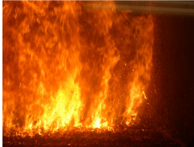
Das Feuer in dem Feuerraum eines Bioenergiewerkes ©Bioenergie Wächtersbach GmbH
