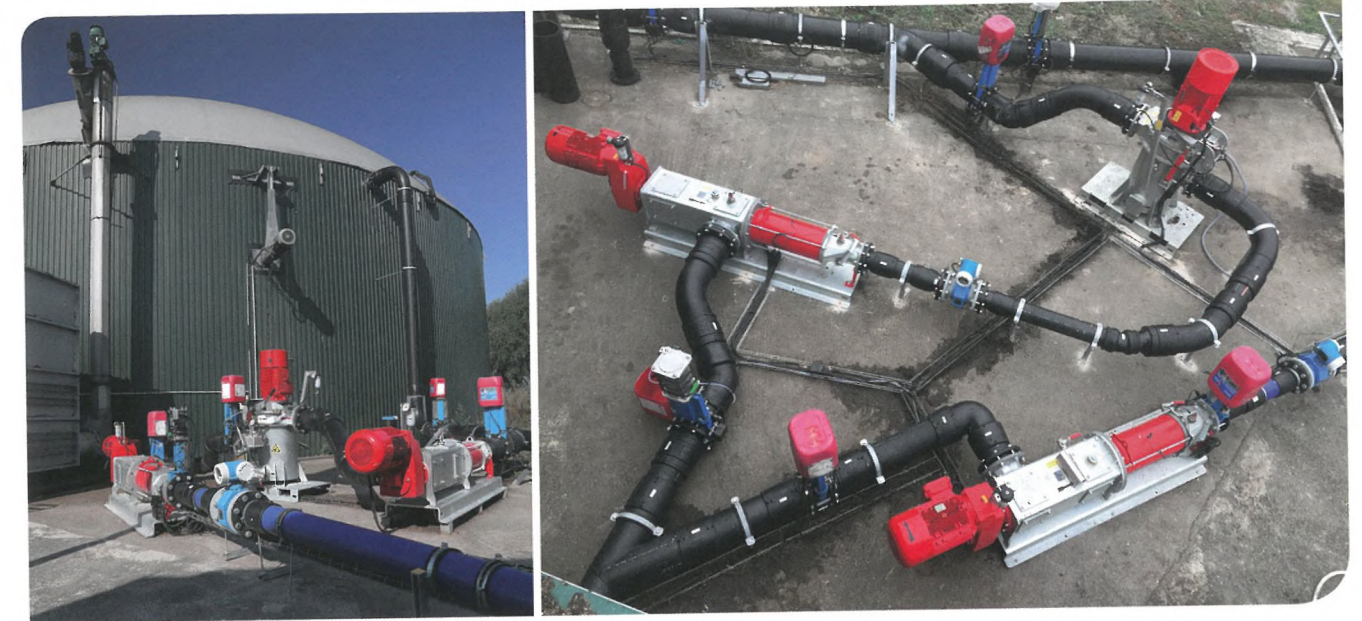
Abbildung 2: Bypassleitung und Versuchstechnik
